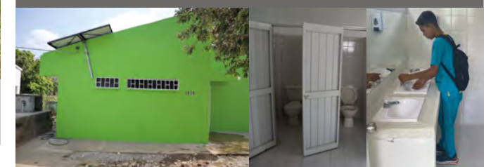
Nous avons rénové entièrement les toilettes et lavabos de l'école de San José à l'intérieur comme à l'extérieur. Elles sont désormais non mixtes et fonctionnelles.
